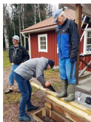
Entrén reparerades av Erik och Mattias. Baktill Micke Blixt med händerna tillfälligt i byxfickorna.
